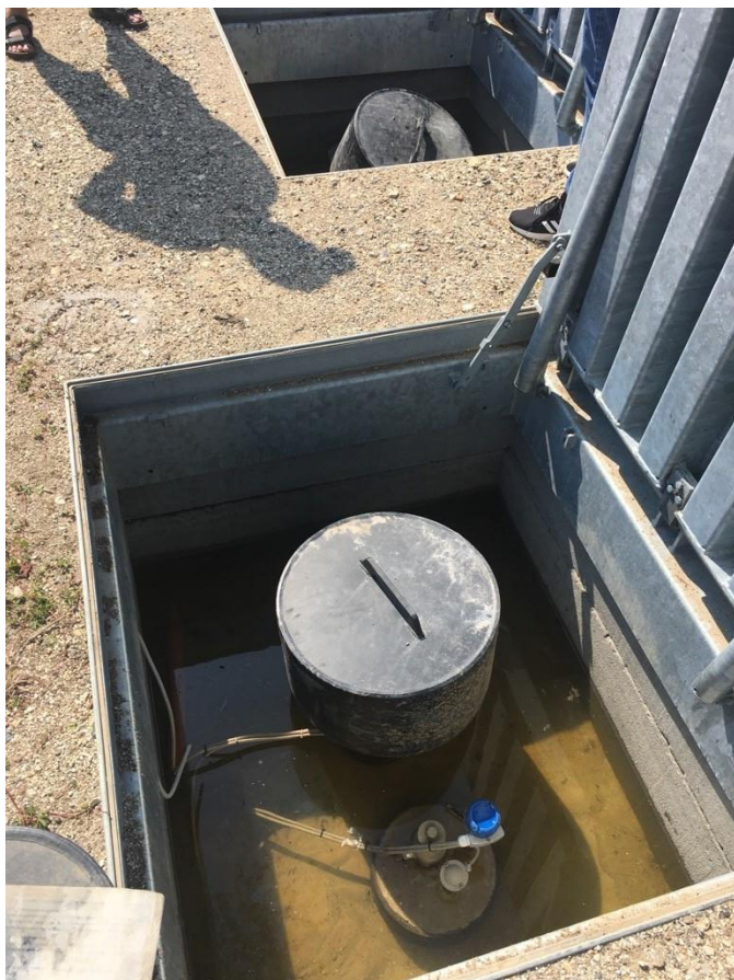
Figur 1-1 Vand i en af de vestlige ventilbrønde.
