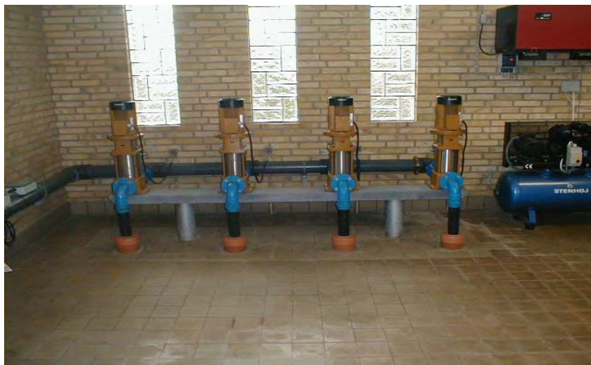
Figur 10. Pumper på Uggeløse Vandværk.
