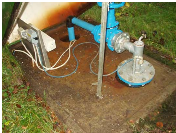
Figur 9. Råvandsstation på boring B3, Ellebæk Vandværk
