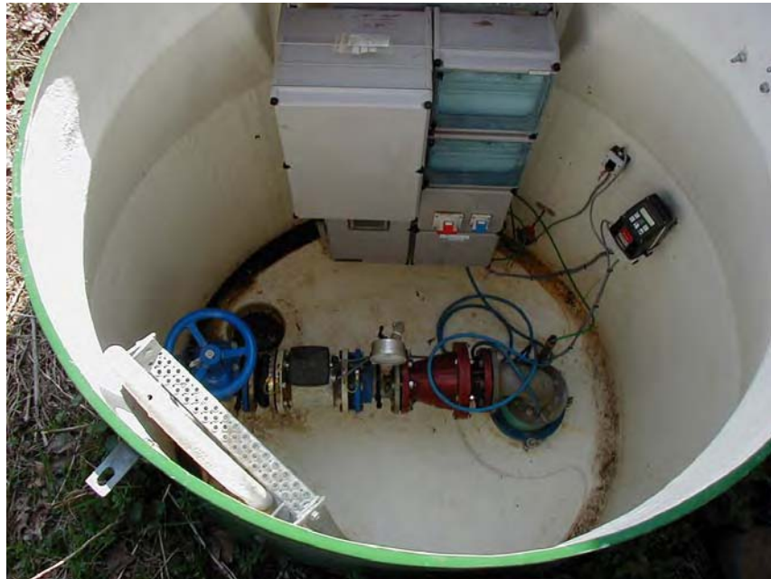
Figur 8. Vandværksboring på Lillerød Vandværk
