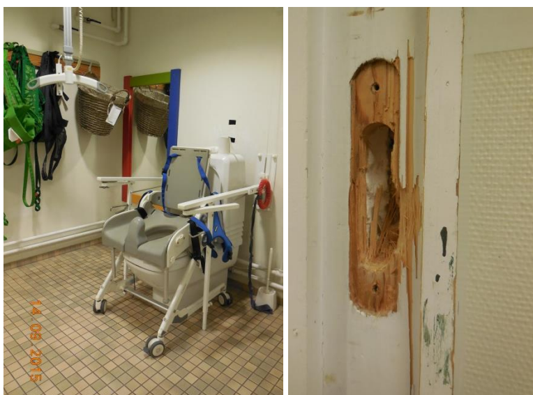
Handicaptollet (I) ved centerafdelingen og defekt lås på dør.
