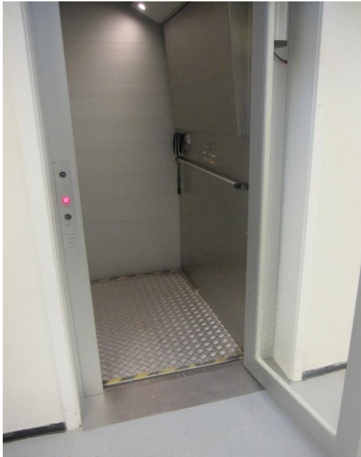
Løfteplatform til skolens kælderetage.
